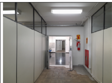
Parede 2º pav. lado 2 – extintor de incêndio
