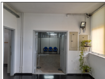
Parede 2º pav. lado 1 – quadros QDAC 13 e QDFL 14
