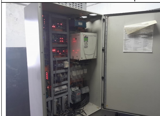
Foto 04 - Quadro de Comando
