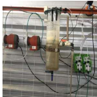
Unidade de coagulação.
