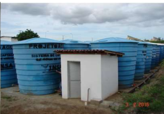
Reservatórios e casa de bombas
