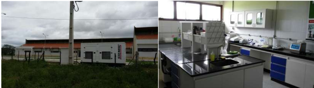
Grupo gerador para laboratórios
