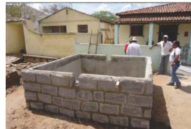
Cisternas de pedras
