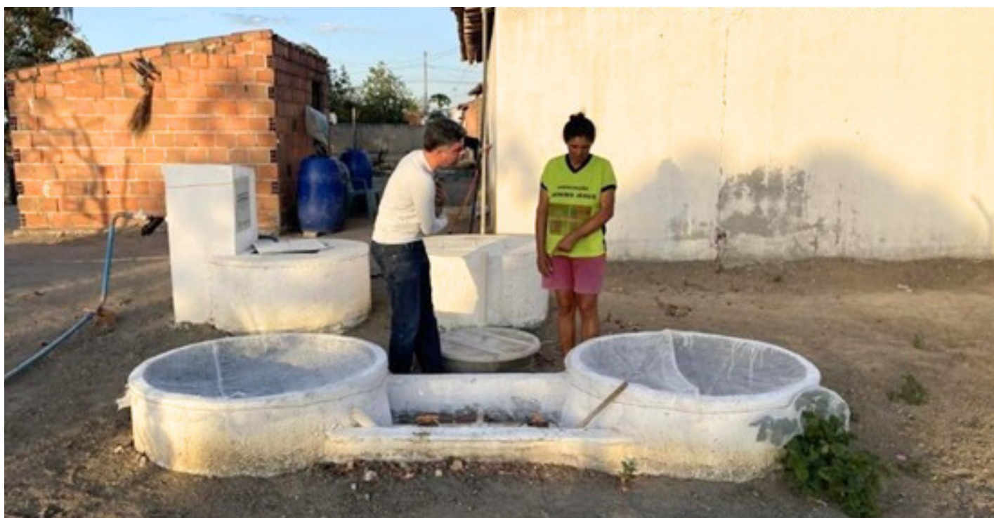
Ação promovida pelo projeto Saneamento rural sustentável: Tratamento de esgoto e reúso de água para produção agrícola na zona rural dos municípios Poço Redondo/SE e Porto da Folha/SE. FOTO: DIVULGAÇÃO/INSA
