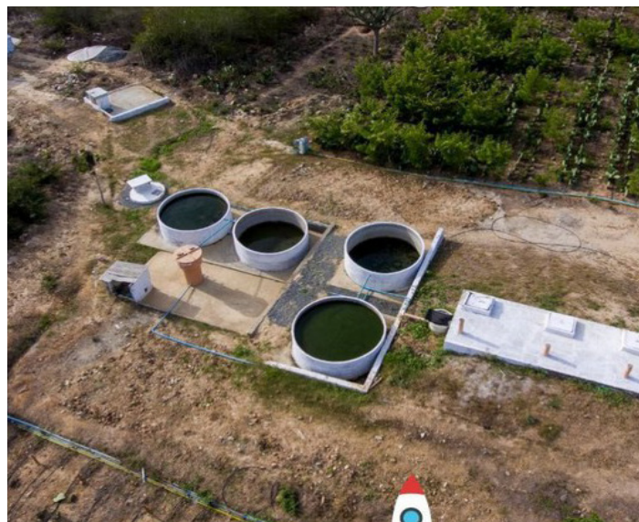
Sistema de tratamento de esgoto implantado pelo INSA/MCTI e PATAAC - Foto: Felipe Lavorato
