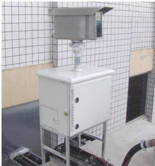
Figura 5.1 – Involucro de proteção para os equipamentos.
