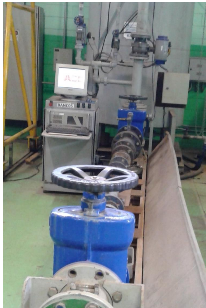
Figura A1 –Bancada de Calibração de Hidrômetros da Empresa - Copasa
