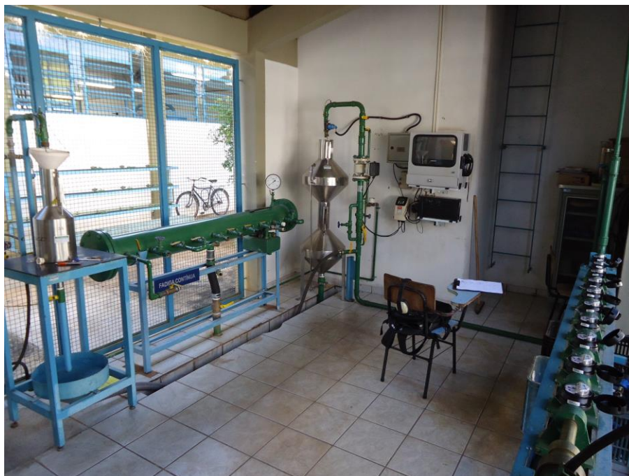
Figura A3 – Bancada de calibração de hidrômetros da empresa SANEAGO
