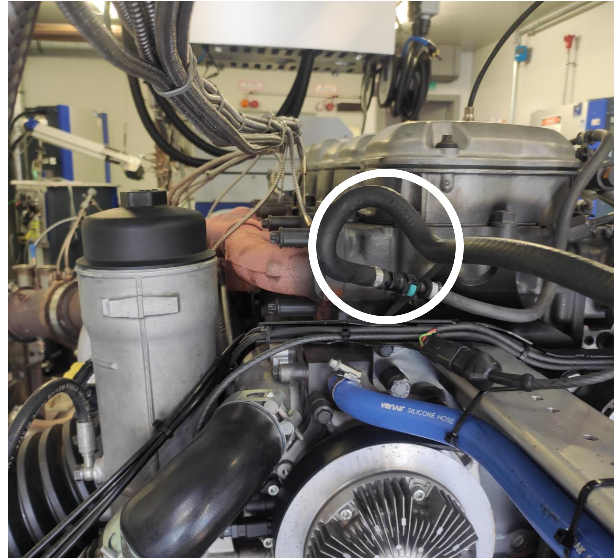
Desaeração do sistema de refrigeração
