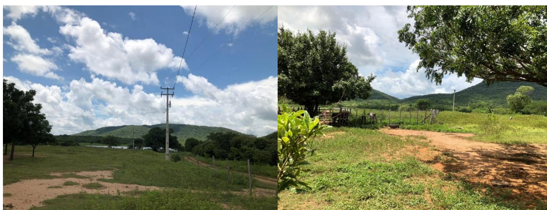
Imagens 11 e 12 - rede energia elétrica no assentamento Jerimum
