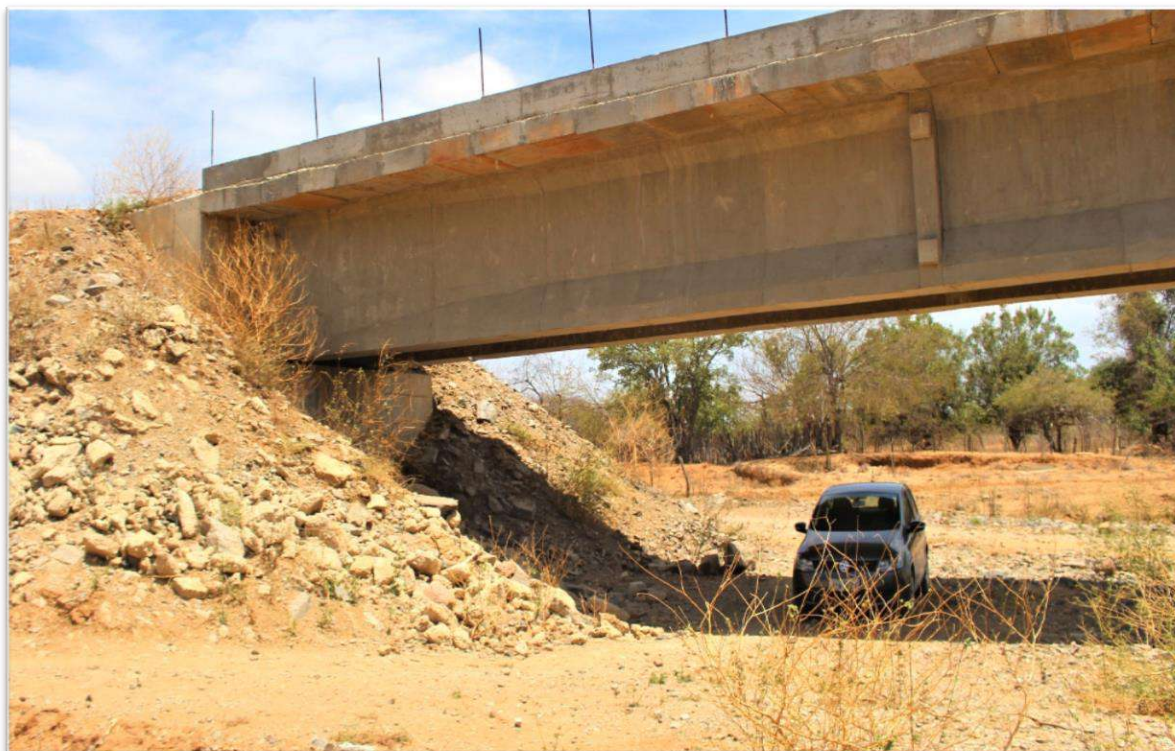
Figura 35 -Ponte por onde passa a ferrovia construída sobre o “Riacho Grande” do Território Contente
