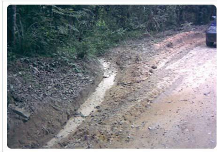
Figura 11: Falta de drenagem
