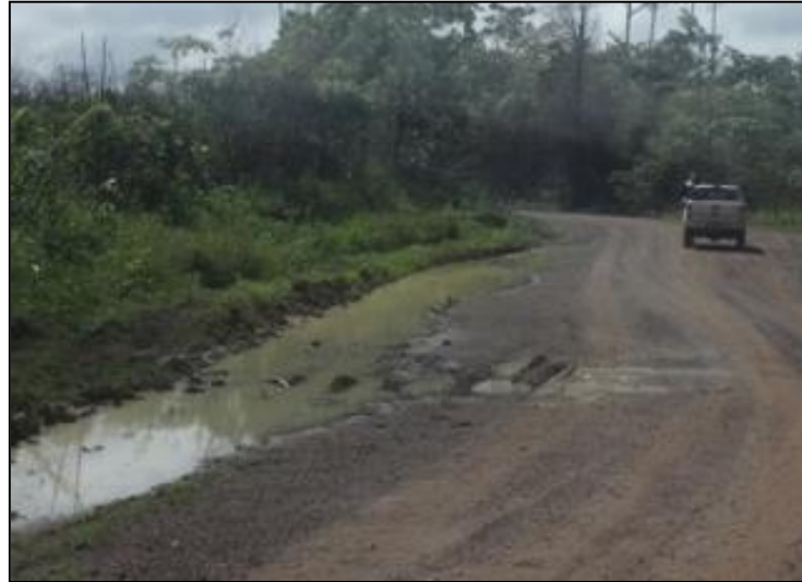
Figura 26: Falta de drenagem superficial – surgimento de buracos - Estrada da Caip
