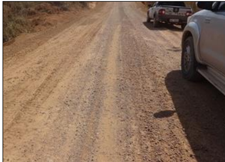
Figura 32: Segregação do agregado 2 - Estrada da Caip
