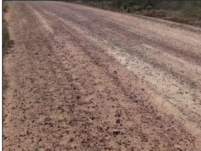
Figura 31: Segregação do agregado - Estrada da Caip
