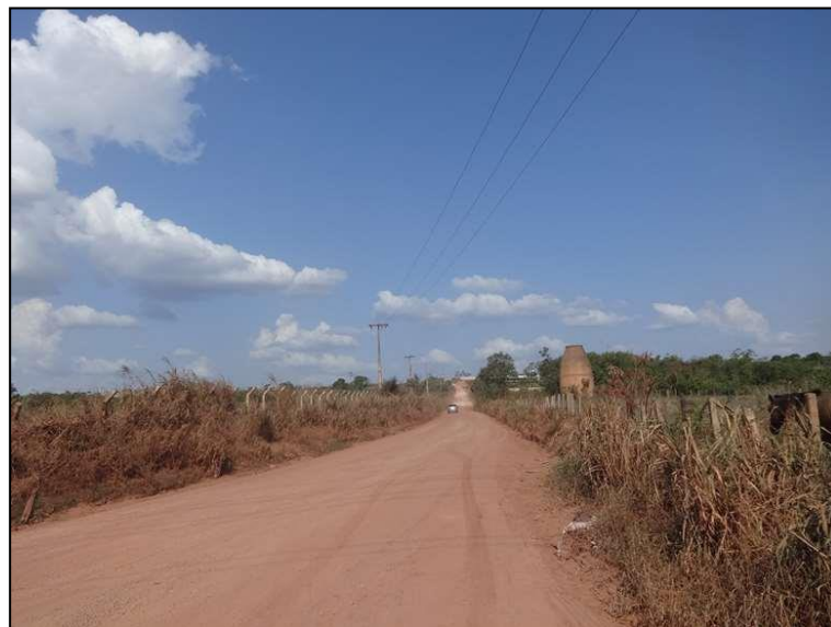
Figura 24: Seção transversal inadequada 2 - Estrada da Caip
