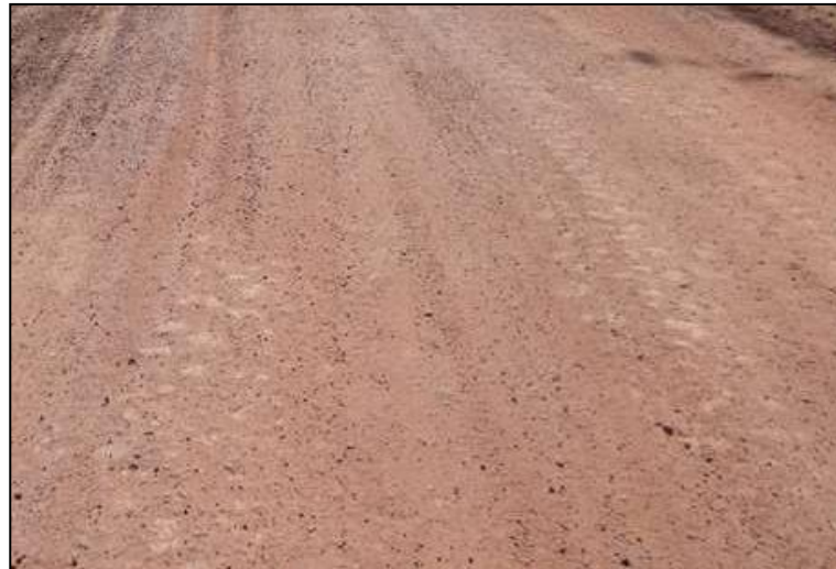
Figura 28: Corrugações 2 - Estrada da Caip
