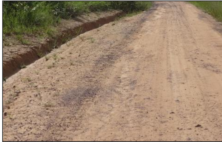
Figura 27: Corrugações - Estrada da Caip
