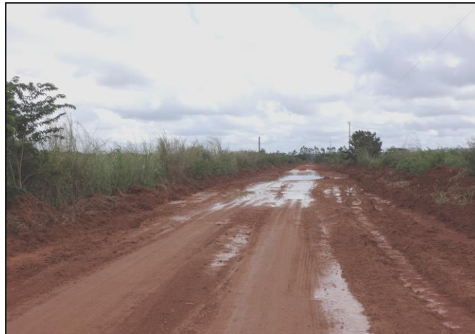
Figura 23: Seção transversal inadequada - Estrada da Caip
