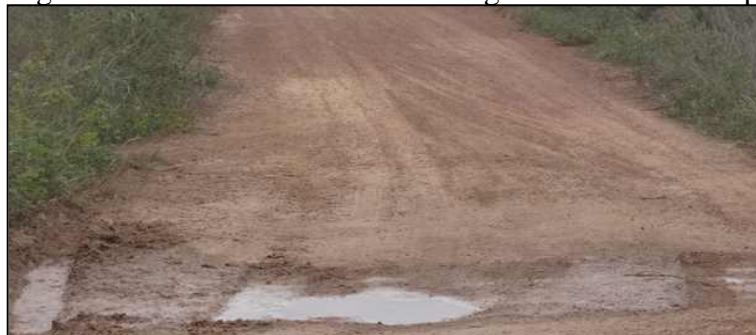
Figura 34: Buraco com acúmulo de água - Estrada da Caip
