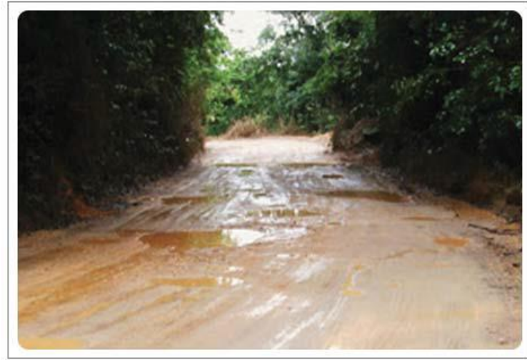
Figura 9: Pista de rolamento danificada por problemas de drenagem
