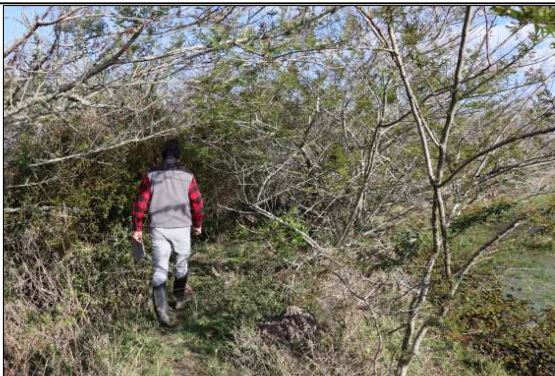
Figura 3. Presença de vegetação excessiva, principalmente do tipo arbóreo-arbustivo ao longo de todo o barramento, no talude de montante, crista e talude de jusante.
