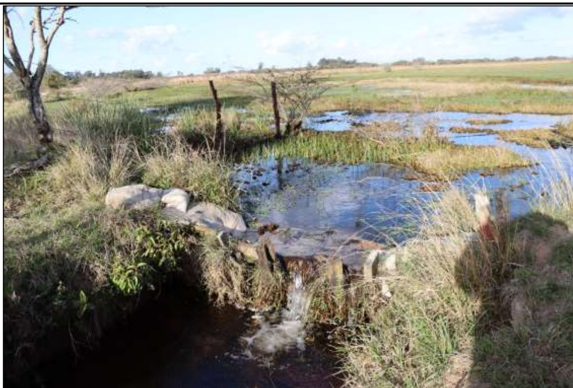
Figura 5. Vertedouro em péssimo estado de conservação e manutenção.
