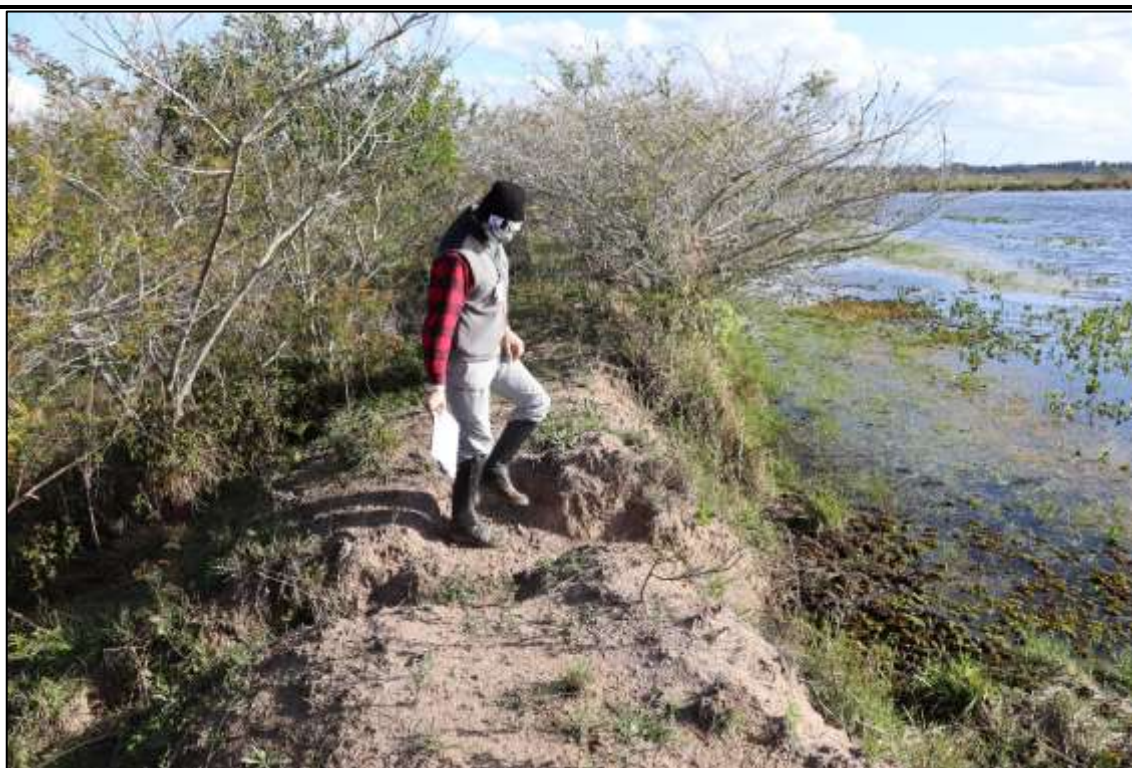
Figura 7. Sinais de galgamento, processos erosivos na crista e nos taludes, e presença de árvores e arbustos.
