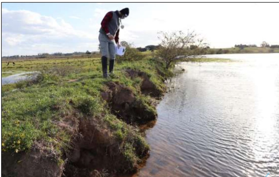
Figura 2. Ausência de enrocamento de proteção, processos erosivos e buracos no talude de montante.
