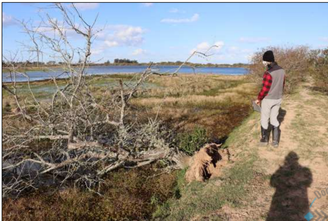
Figura 4. Tombamento de árvore localizada na junção da crista com o talude de montante.
