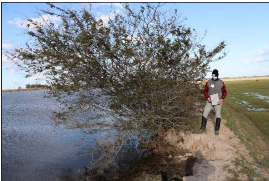
Figura 6. Presença de árvores e estreitamento severo da crista.
