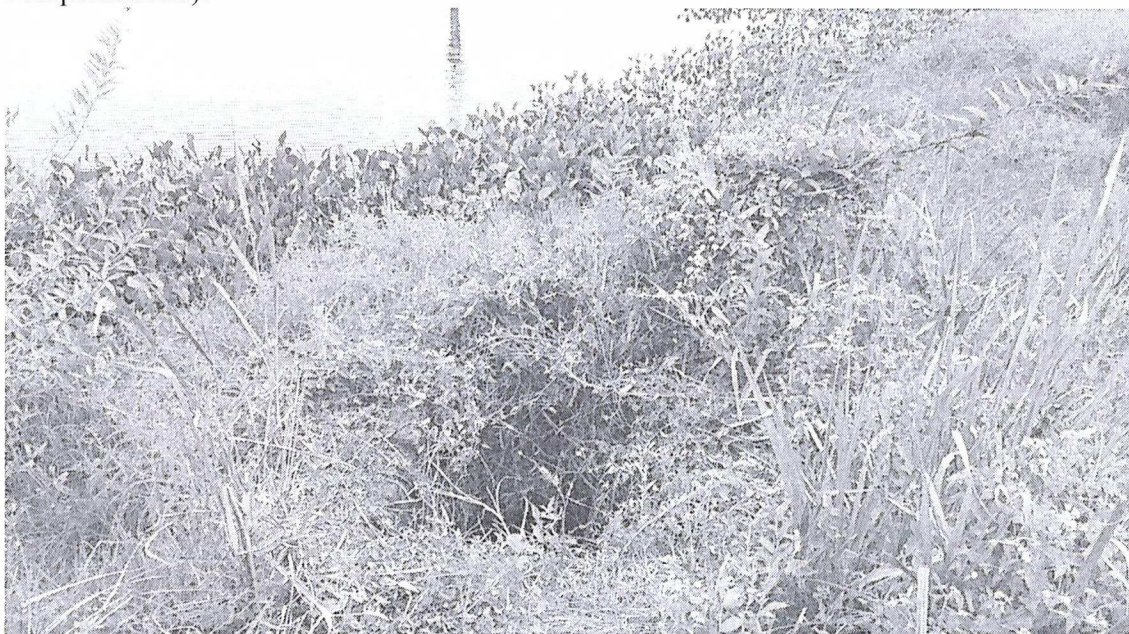
Figura 3. Excesso de vegetação no vertedouro 2 (sem manutenção e com funcionamento comprometido).
