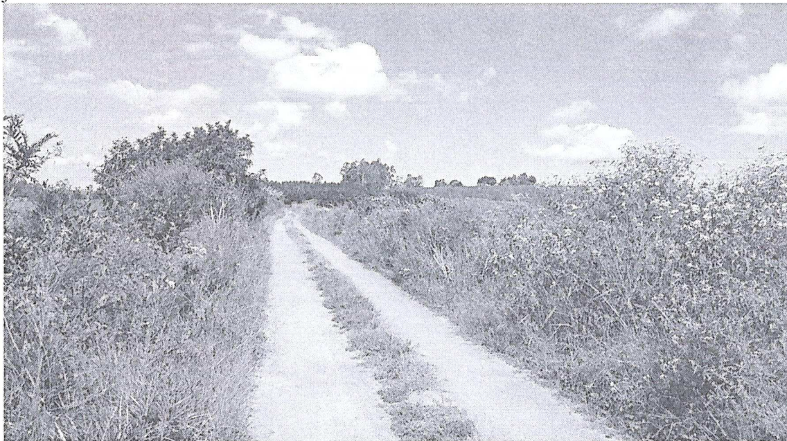
Figura 1. Crista da barragem com presença de vegetação nos taludes de montante e jusante.
