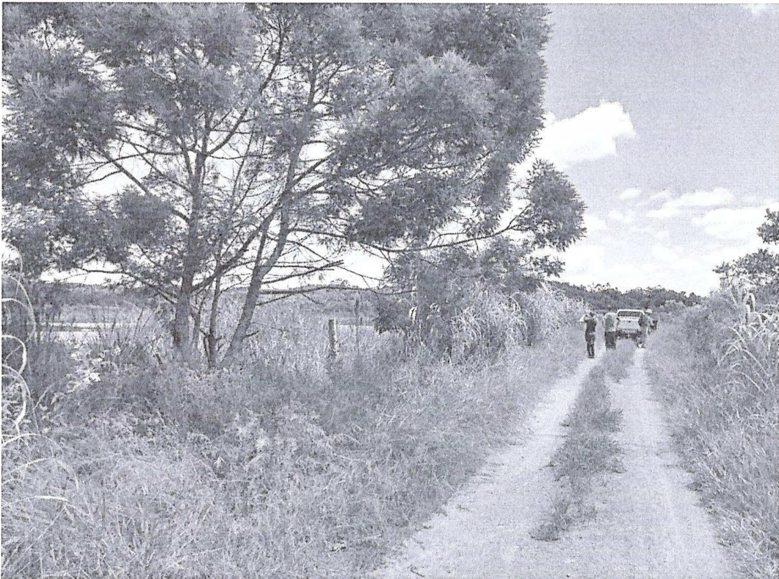
Figura 5. Presença de vegetação com porte alto no talude montante.
