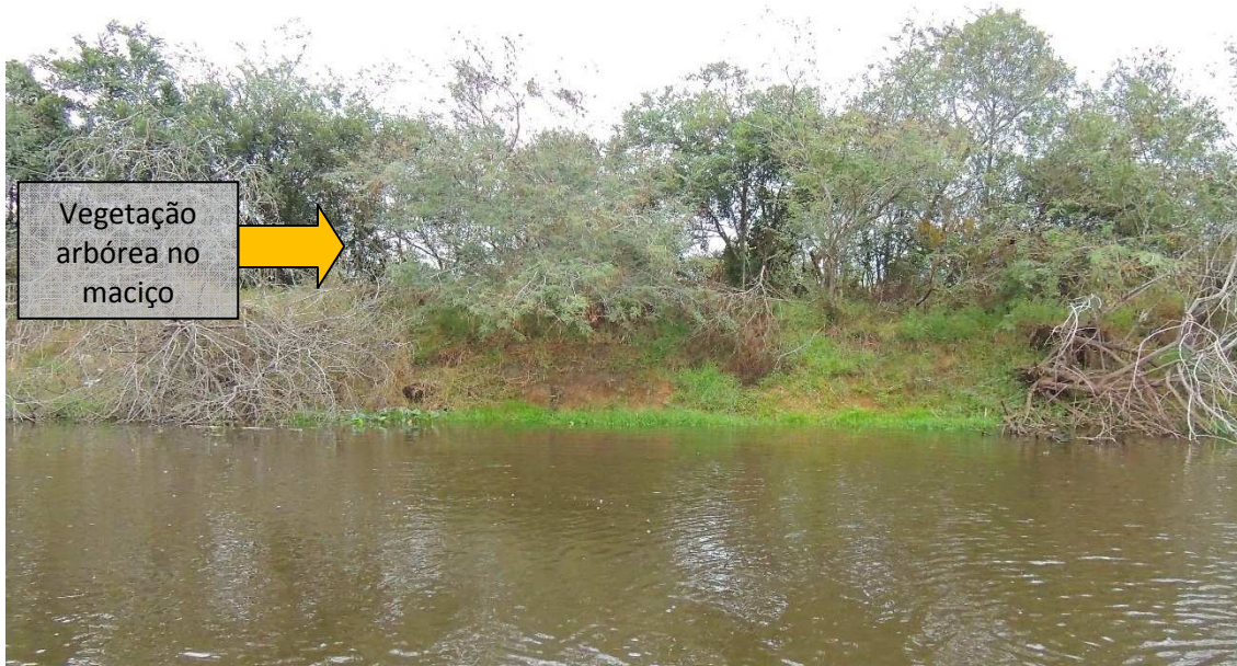
Fig.4: Barragem de cima: Maciço onde se localiza a estrada municipal, com erosão e sem enrocamento.
