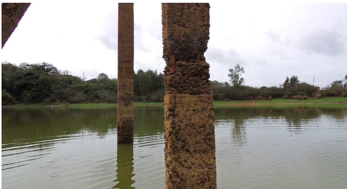
Fig 8: Barragem do Seu João: Visão de jusante para montante e detalhes das colunas da passarela e da água mostrando eutrofização.
