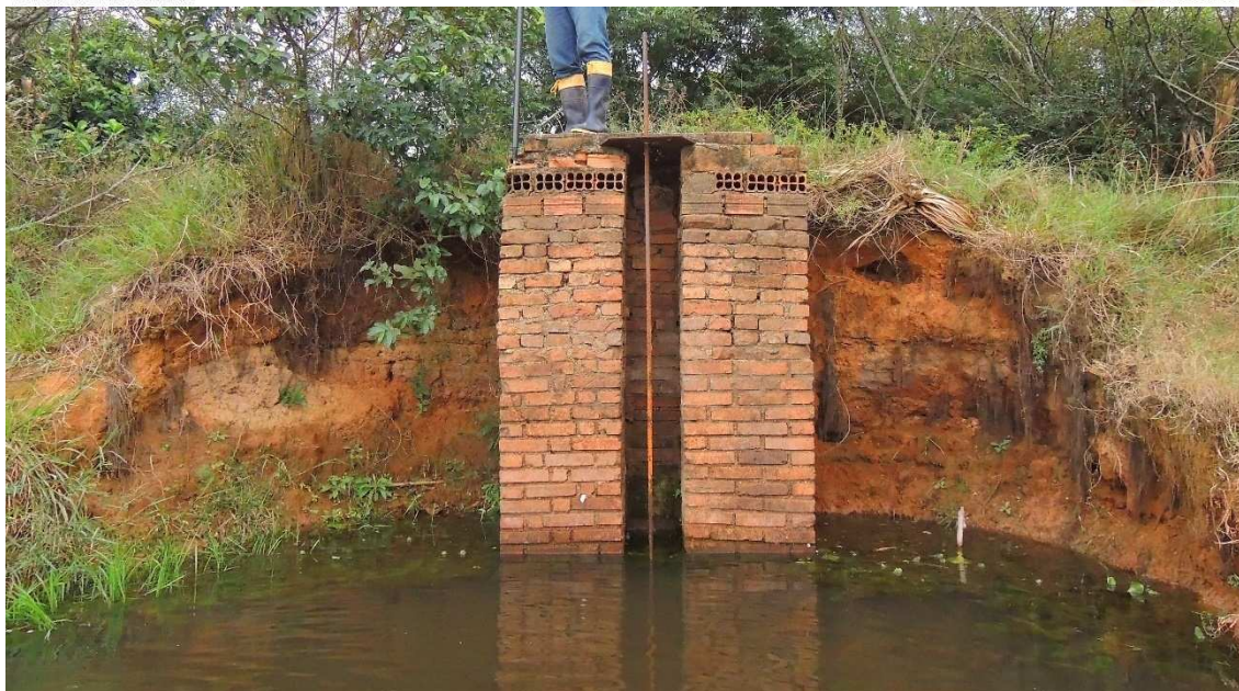
Fig 5: Barragem de cima: Comporta com mecanismo de acionamento da válvula.
