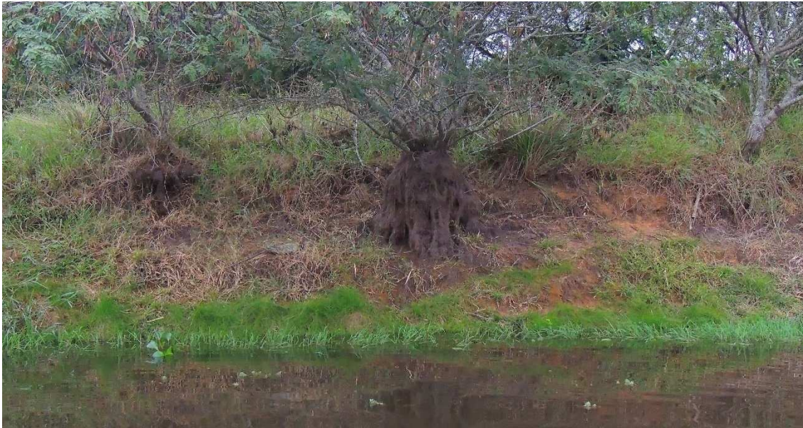
Fig 3: Barragem de cima: Maciço sem enrocamento e com vegetação arbórea.
