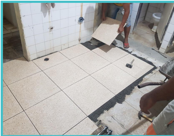
Figura 37: Banheiro dos tratadores de peixes-bois
