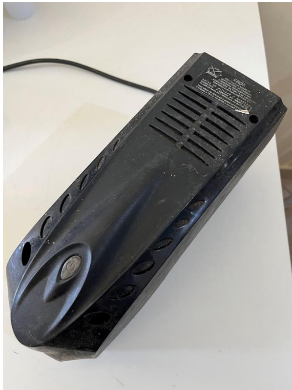
Nobreak SMS New Station (n.s. 279100042136)
