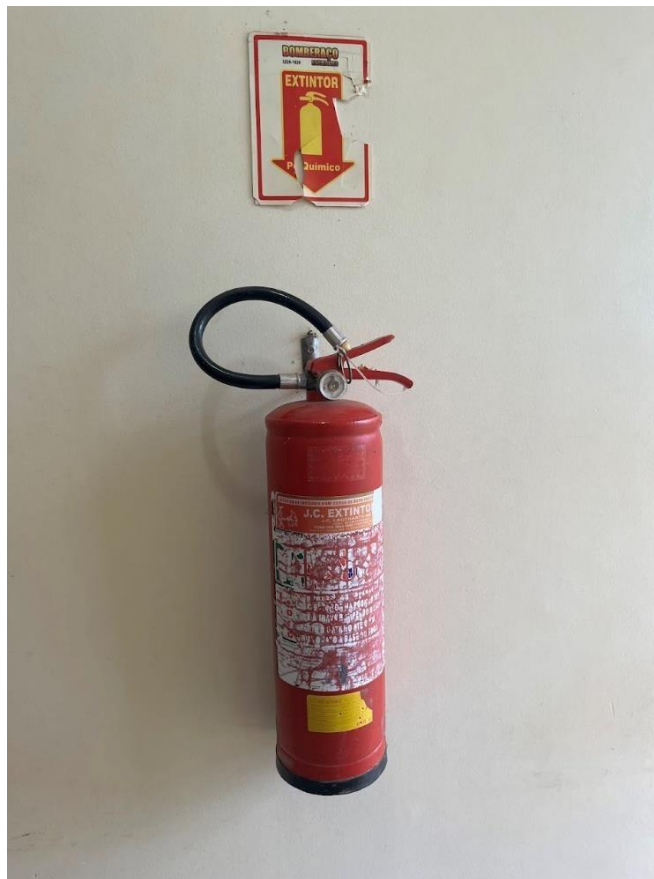
Extintor de incêndio com carga de pó químico
