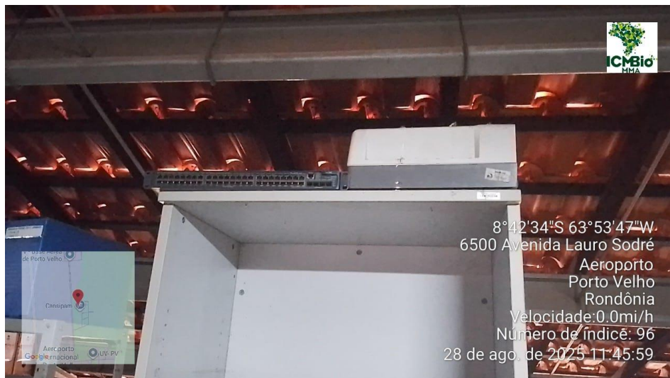
Figura 9 SWITCH E PABX: ITENS 110 E 70
