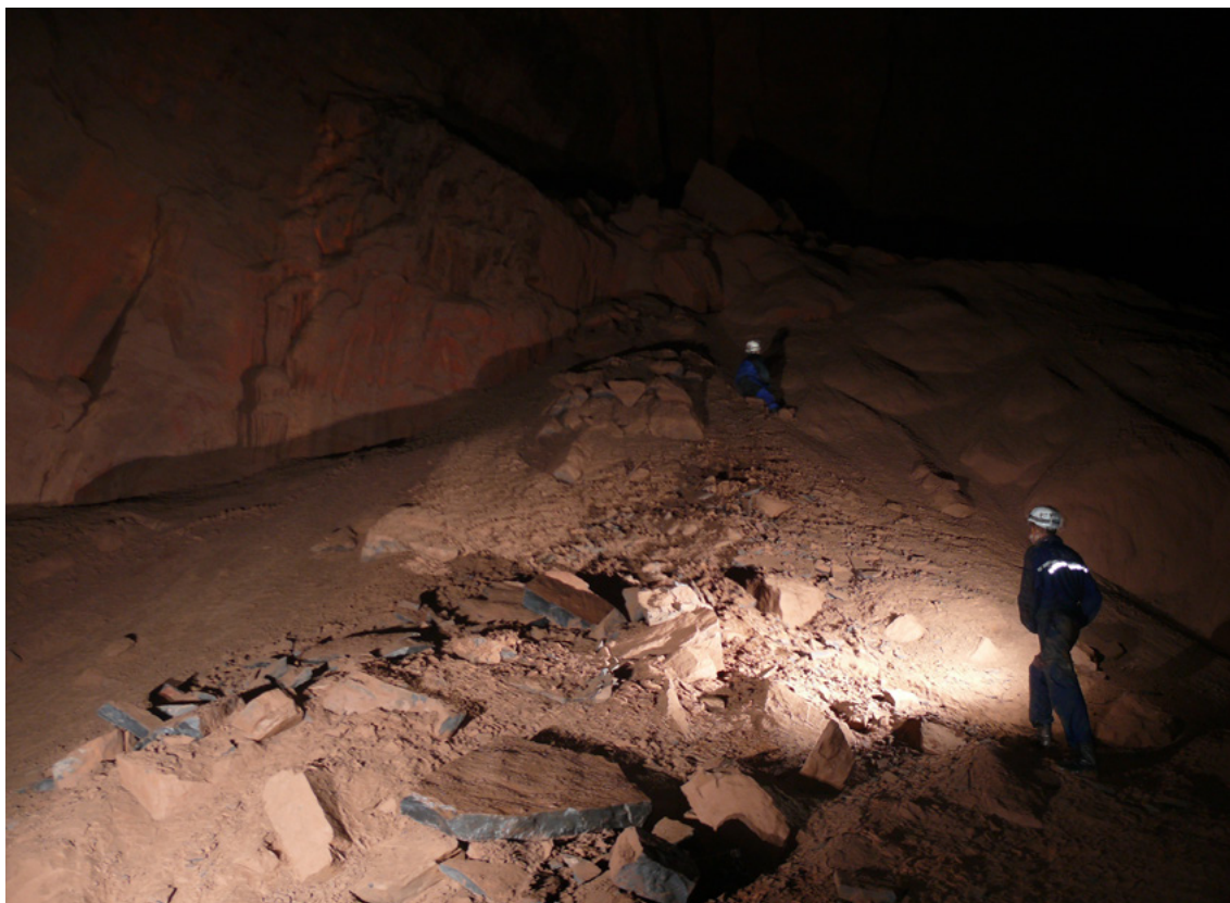
Figura 12 – Colapsos de rocha do teto na caverna Buraco do Inferno da Lagoa do Cemitério (BA), São Desidério. Este ponto coincide em superfície com as obras de pavimentação e detonação de rochas mostradas na foto anterior Foto: Cristiano F. Ferreira
