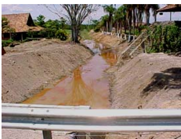
Fig. 6.44: Alteração de drenagem
