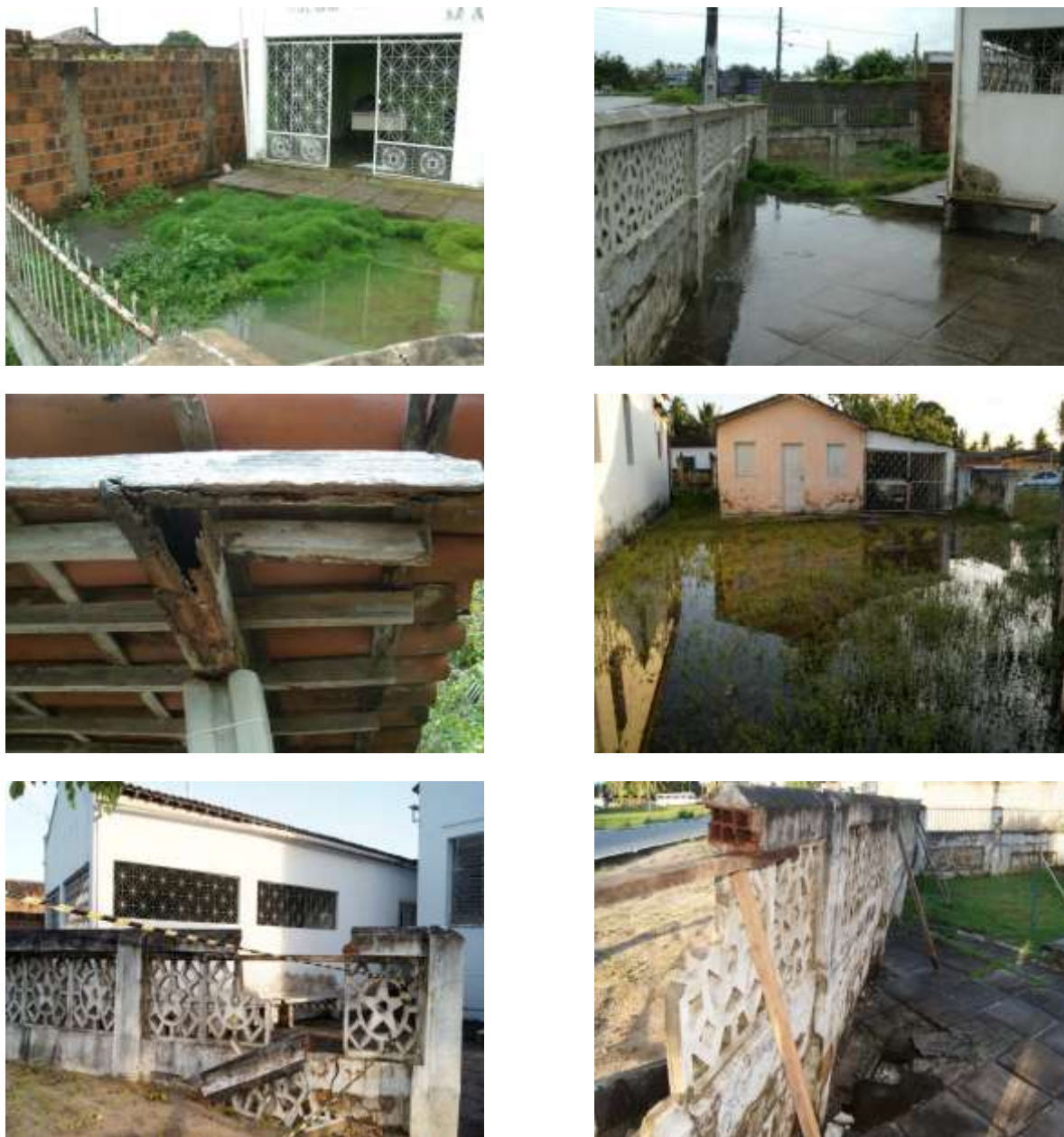
Figura 90 - Imagens das edificações da sede em Rio Tinto e suas precárias condições.
