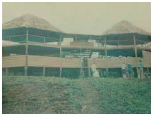
29. Estrutura para hospedagem construída pela comunidade do Cazumbá na localidade Gama, igarapé Maloca
