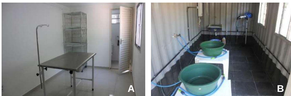
Figura III.3.4-3 – Área interna dos contêineres. A) Container ambulatório com mesa de procedimento em aço inox e suportes para soro. B) Contêiner de lavagem com sistema de aquecimento de água pressurizado (2 saídas de água), água fria (2 saídas) e secador do tipo pet.
