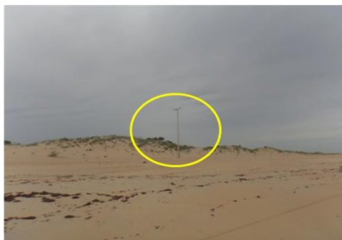
Figura 3 - Postes com linhas de transmissão de energia de baixa visibilidade na linha de costa do município de Galinhos/RN.
