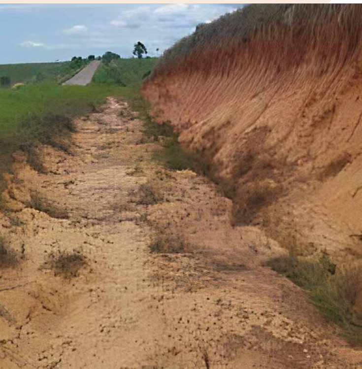
Figura 5.1.4 Demonstração de erosão e desmoronamento em barranco de Latossolo Vermelho-Amarelo na área estudada
