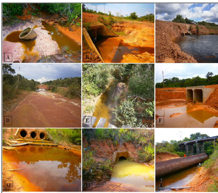
Figura 6. Situação presenciada nos pontos de coleta. A) Restos de obra no curso d'água; B) e C) solo exposto; D) ausência de vegetação na APP; E) bueiro metálico deixado no curso d'água; F) obra recente, solo exposto; G) bueiro elevado; H) bueiro semiafogado; I) bueiro sem uso abandonado no leito do curso d'água.
