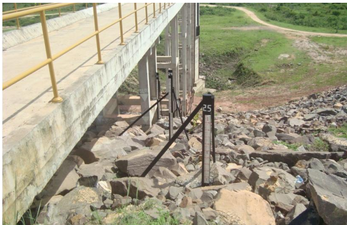
Figura 2.9– Vista a montante do talude da Represa do rio Poxim-açu. Detalhe das réguas instaladas para acompanhamento do enchimento da represa. Fonte: autor.
