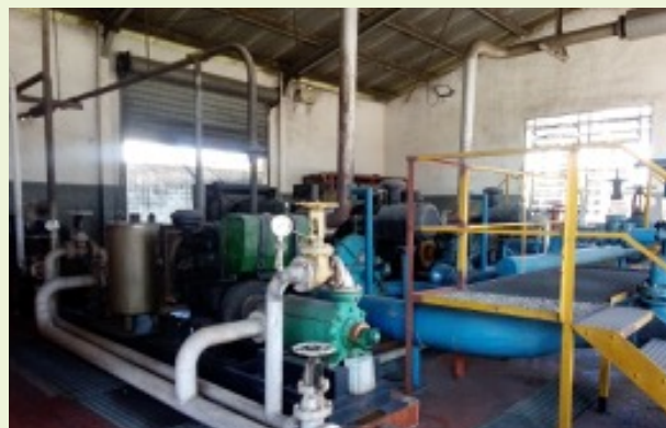
Sistema de combate a incêndios
