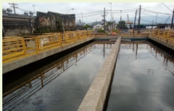
Tratamento de efluentes
