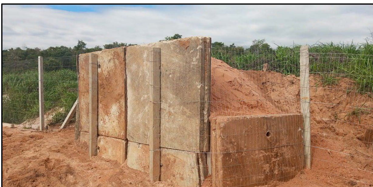
Figura 8 - Exemplo de jump-out implementado em Rondonópolis/MT (Rumo Malha Norte). Foto: Rumo.
