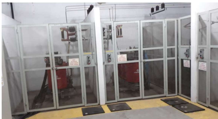
Figura 52: Subestação e grupo motor-gerador após reforma
