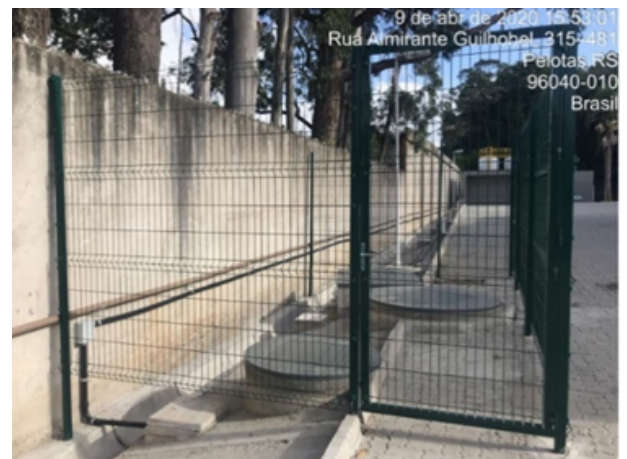
Figura 1. Tratamento de esgoto
