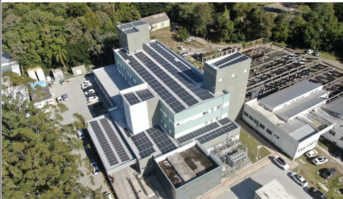
Imagem da cobertura do Bloco 3 com o sistema instalado
