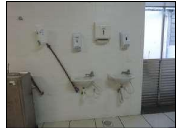
Bebedouro localizado no refeitório, ausência de coletores de copos plásticos.
