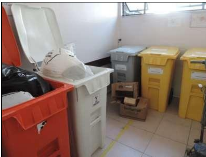
Figura 8: Local para armazenamento temporário interno de resíduos comuns e infectantes. Resíduos comuns são acondicionados nas lixeiras alaranjadas e os resíduos infectantes nas lixeiras brancas. Em vários expurgos internos há também o acondicionamento de roupas (lixeiras amarelas e cinzas).
