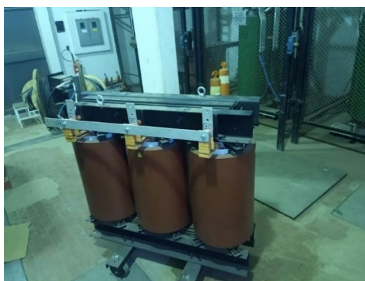
Imagem 7 – Transformadores a seco – Depois
