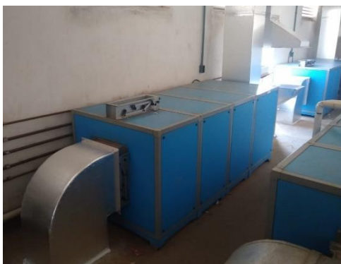
Imagem 8 – Sala de máquinas
