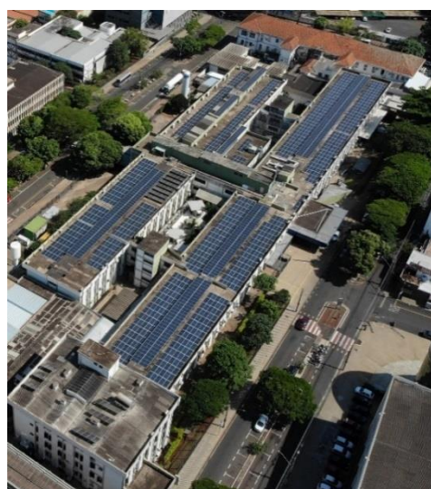
Imagem 14 - Foto da Usina Fotovoltaica
