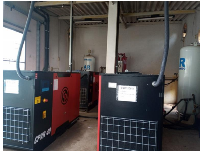
Imagem 4. Novos compressores já instalados
