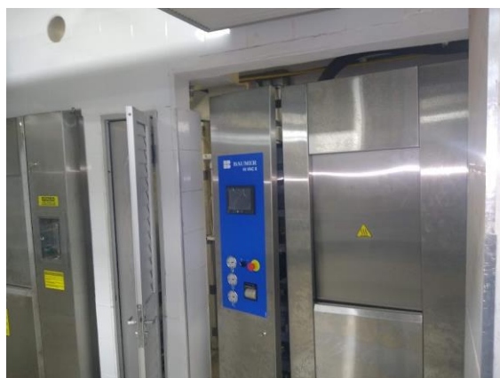
Imagem 30 – Autoclave instalada em CME, previamente adequada
