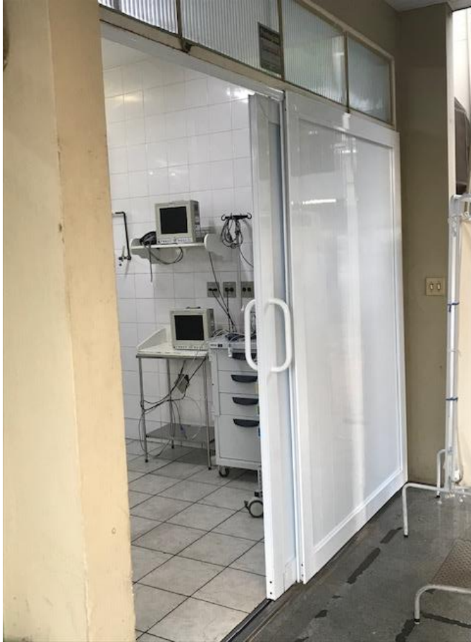
Imagem 32. Instalação de uma porta de alumínio na entrada externa da sala de emergência do PSA
