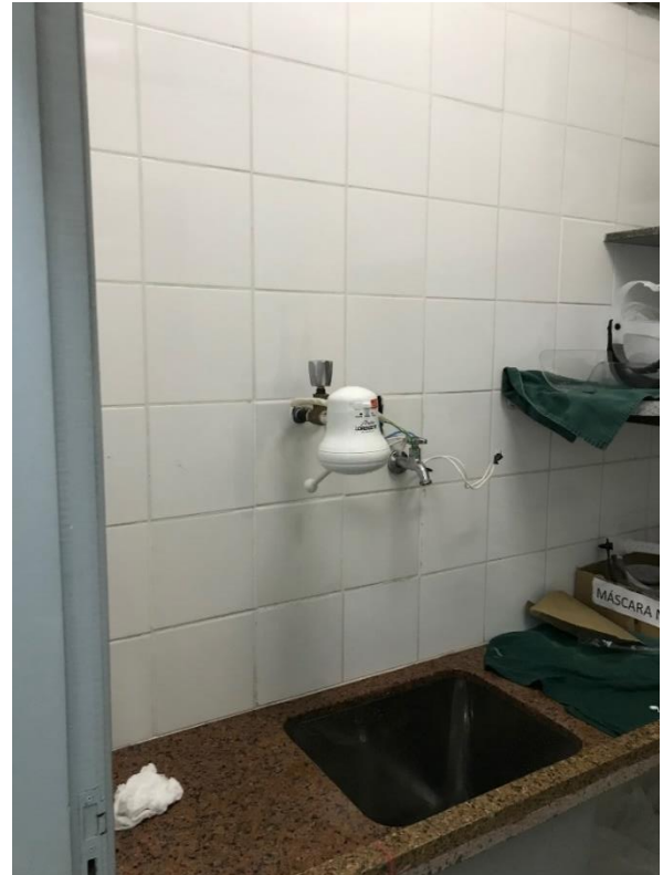
Imagem 17. Detalhe da instalação de chuveiro elétrico dentro da área Covid de um dos equipamentos da hemodinâmica
