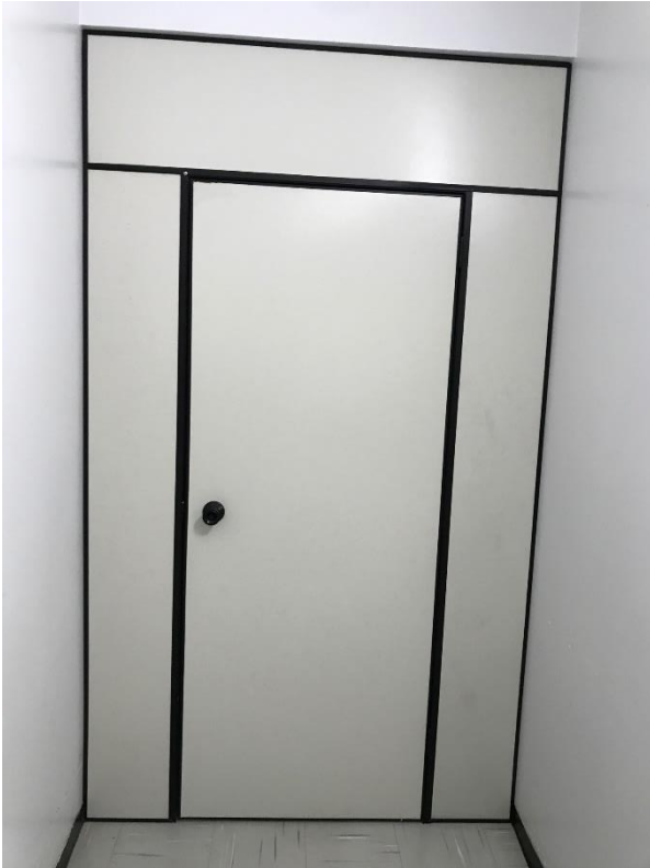
Imagem 16. Detalhe da instalação de uma divisória com porta na circulação que une os dois equipamentos da hemodinâmica para separação de um equipamento para atender casos Covid
