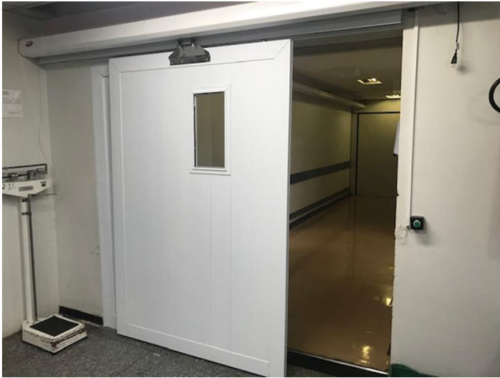
Imagem 12. Detalhe da porta de alumínio instalada na entrada do Hospital da Mulher que dá acesso à circulação do terceiro pavimento do HC-UFTM
