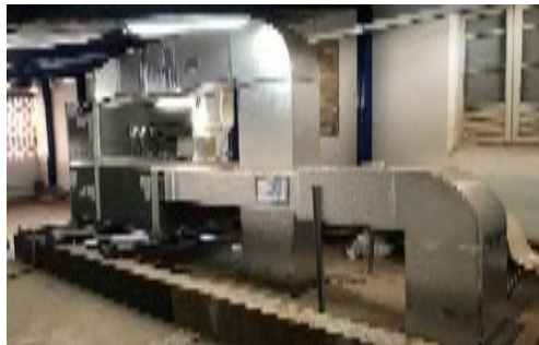
Imagem 10 - Sala de máquinas (tomografia da Santa Casa)
