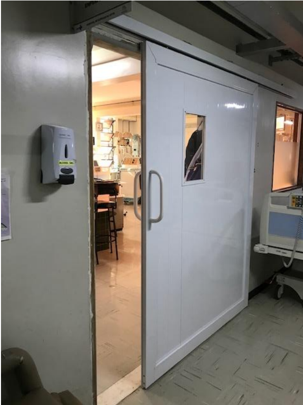
Imagem 24. Detalhe da porta de alumínio instalada na entrada da UTI adulta
