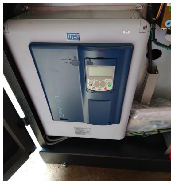
Imagem 5. Inversor dos compressores instalado
