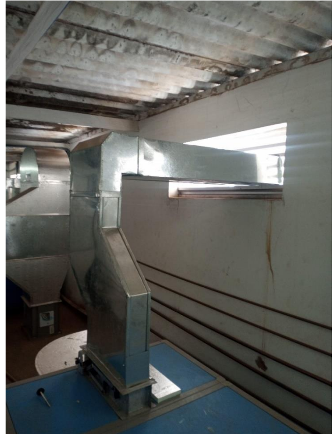
Imagem 7. Detalhe da instalação do duto de troca de ar com o meio externo
