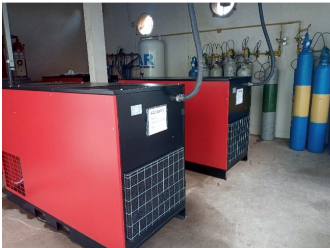
Imagem 20 – Compressor de ar instalado na central de ar medicinal
