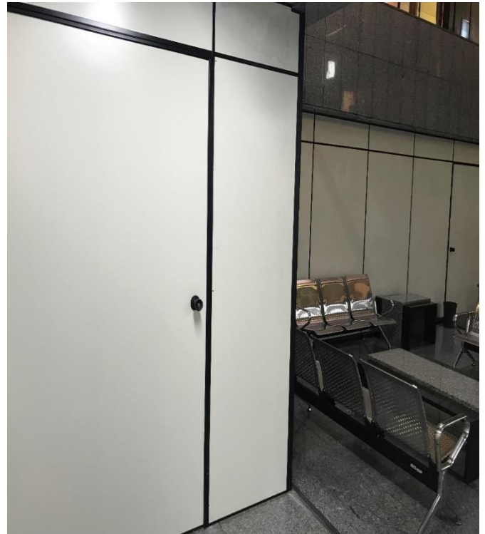
Imagem 13. Detalhe da instalação das divisórias no segundo pavimento do Hospital da Mulher para criar a área Covid
