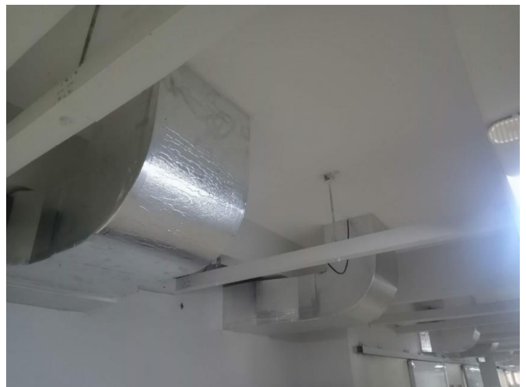
Imagem 9. Detalhe do duto ligando a casa de máquinas com a sala de cirurgia
