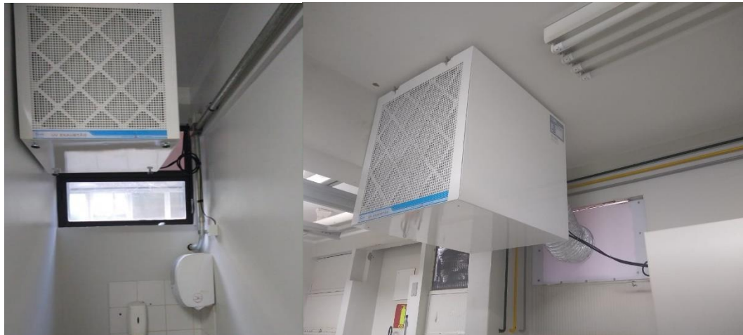
Imagem 15 – Conjuntos portáteis de exaustão com filtragem.
