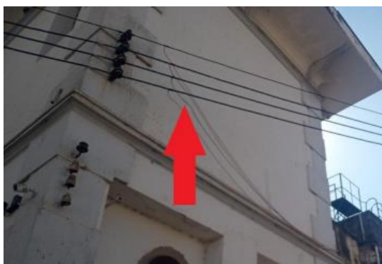
Imagem 37 – Instalação elétrica da Santa Casa
