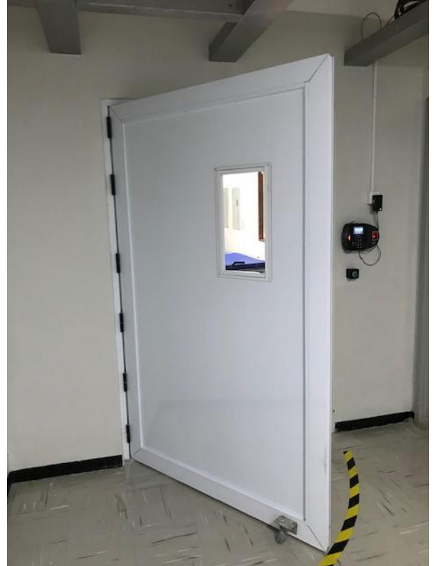
Imagem 25. Detalhe da porta de alumínio instalada na entrada da circulação das UTIs com a circulação da hemodinâmica
