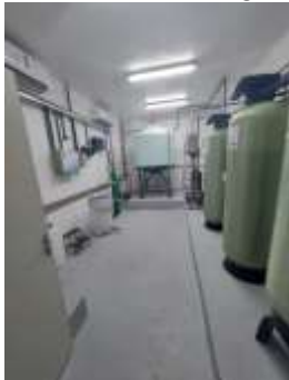
Figura 133 – Sala de Tratamento de Água de Hemodiálise.
