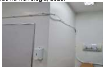
Sala de hemodiálise
