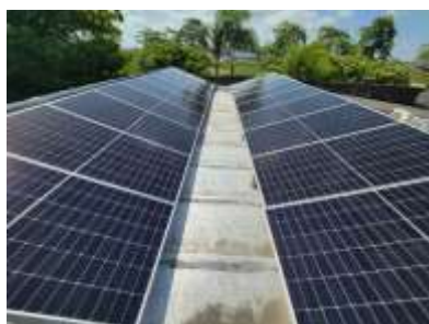
Figura 134 – Micro usina de energia solar instalada sobre a laje do Cacon.
