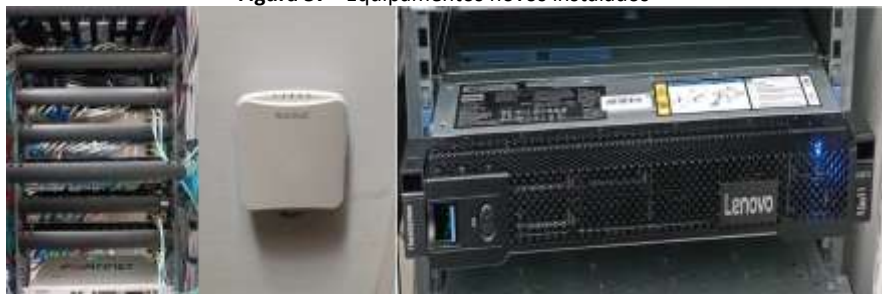
Figura 57 - Equipamentos novos instalados
