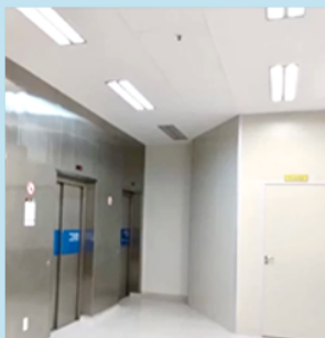
Instalação de divisória para ambiente de banheiros fora da área restrita no 4º e no 5º andar do ECI
