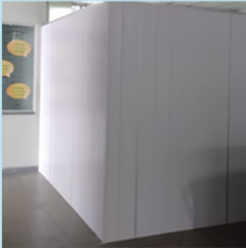
Divisória entre as áreas de circulação do pavimento térreo do ambulatório Covid-19 / não Covid-19.
