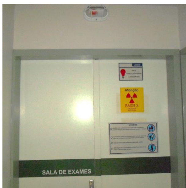
Figura 32: Avisos e sinalização da sala de Hemodinâmica.
