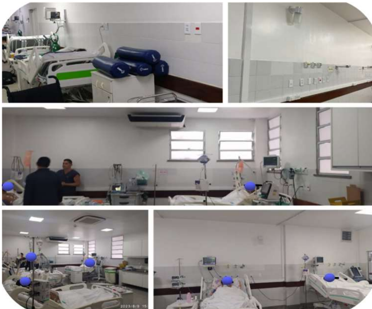
Imagem 46: Adequações elétricas, rede de gases com reposicionamento e embutimento das réguas, reposicionamento do ar-condicionado da Vermelha, troca de películas das janelas e outras.
