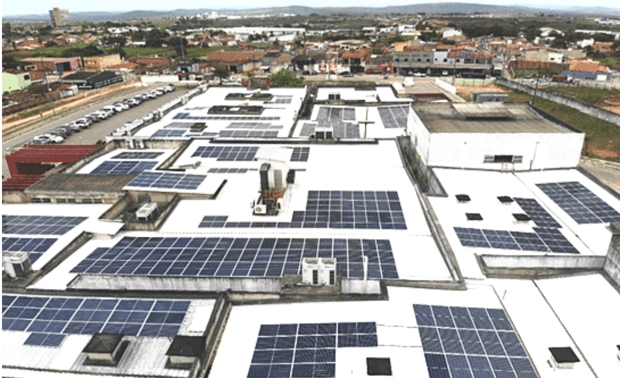
Instalações das usinas fotovoltaicas
