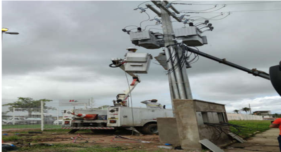
Instalação de Transformador do Hospital de Campanha do HUL
