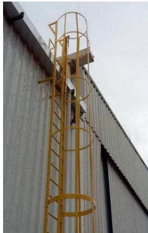
Figura 11 – escada fixa vertical
