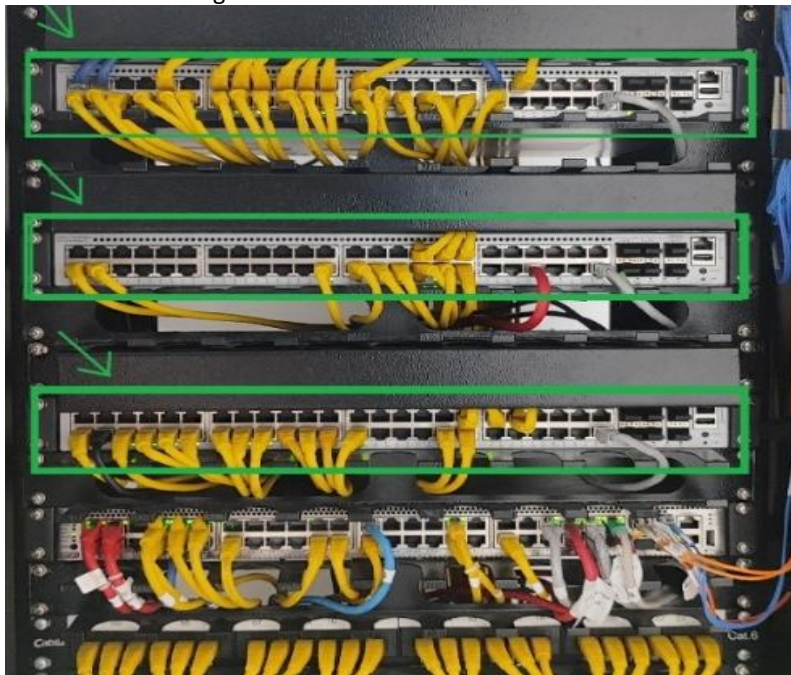
Figura 58 - Switches - Térreo Anexo I
