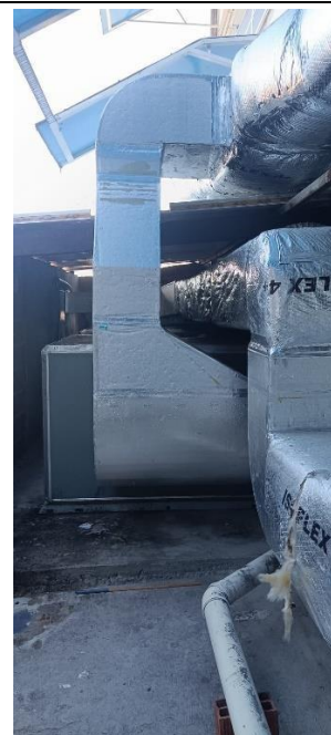
Dutos de Climatização
