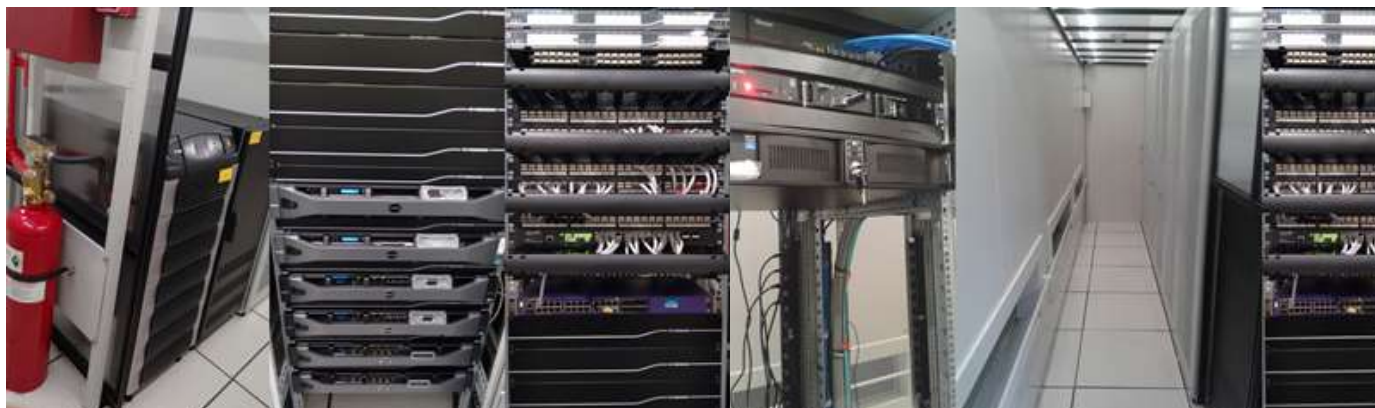
IMAGEM 99 - Equipamentos no Datacenter.
