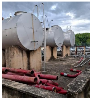
Imagens da Área de tanque de diesel
