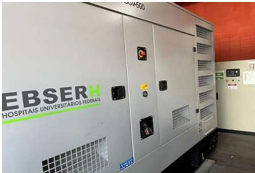
Figura 58. Grupo Gerador de Energia
