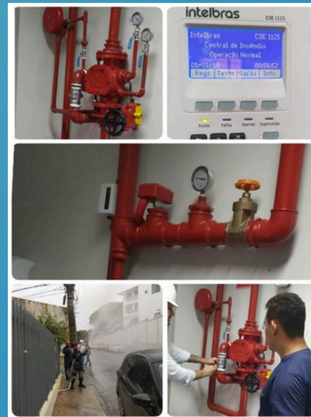
Figura 44. Revisão de sistema de combate a incêndio.
